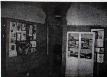
Vlhkosťou poškodená stena v čakárni gynekologickej ambulancie. Foto Sýkora
