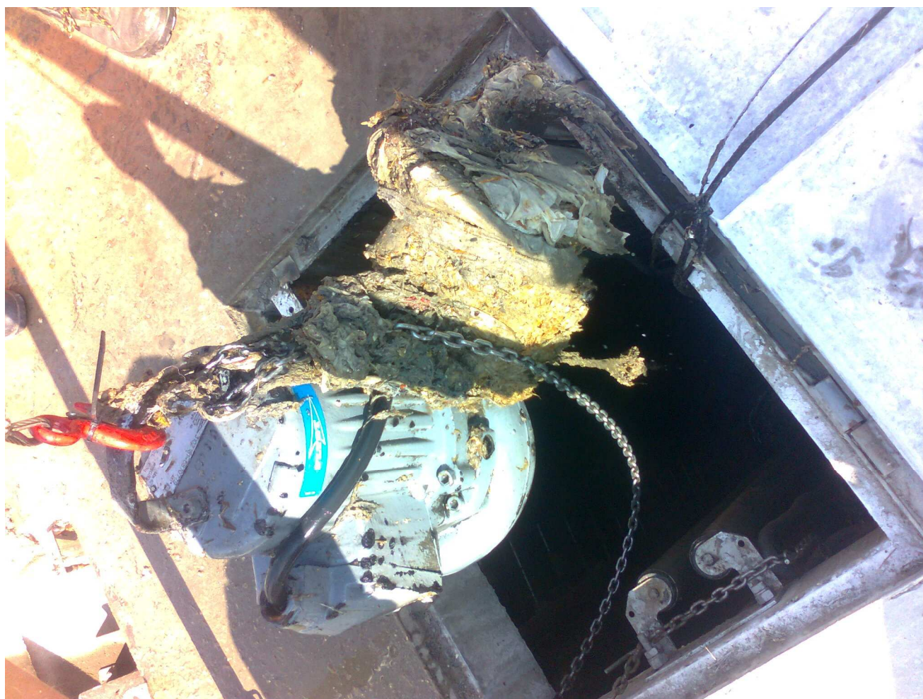
Obehové čerpadlo obalené odpadom
