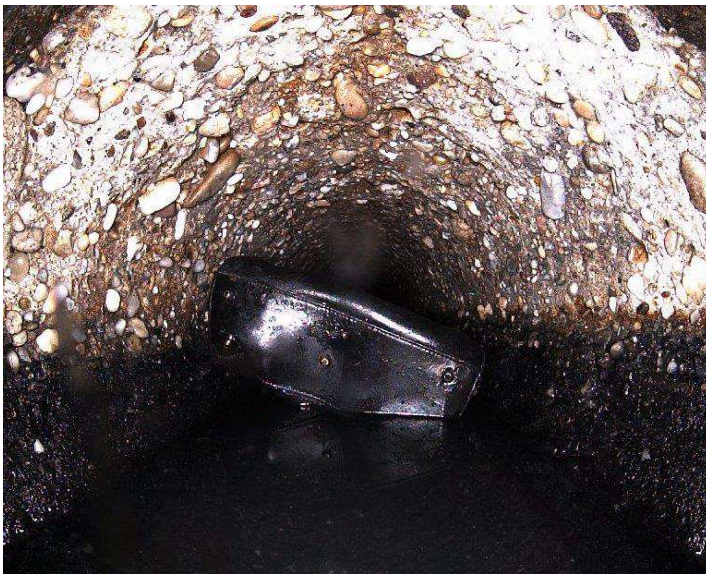
Kabelka v kanalizácii
